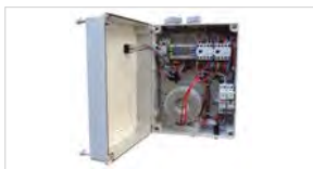
13 Cuadro eléctrico para motor cajón estanco
