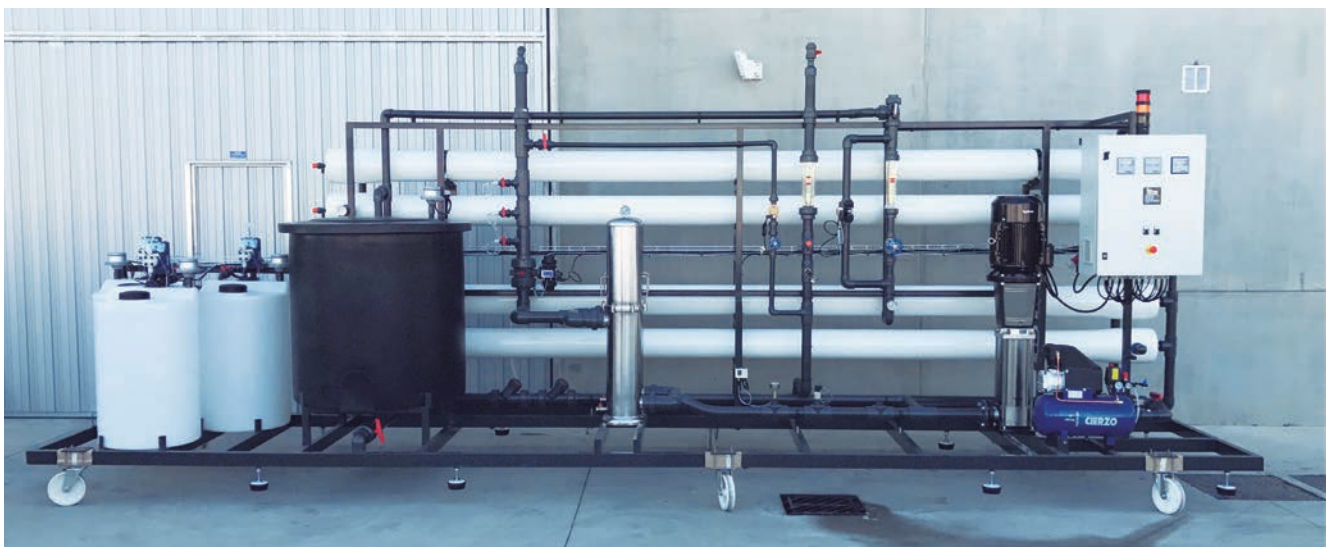
Planta de ósmosis inversa de 400 m 3 /día para un tratamiento de caldera de vapor, instalada en Relizane (Argelia).
