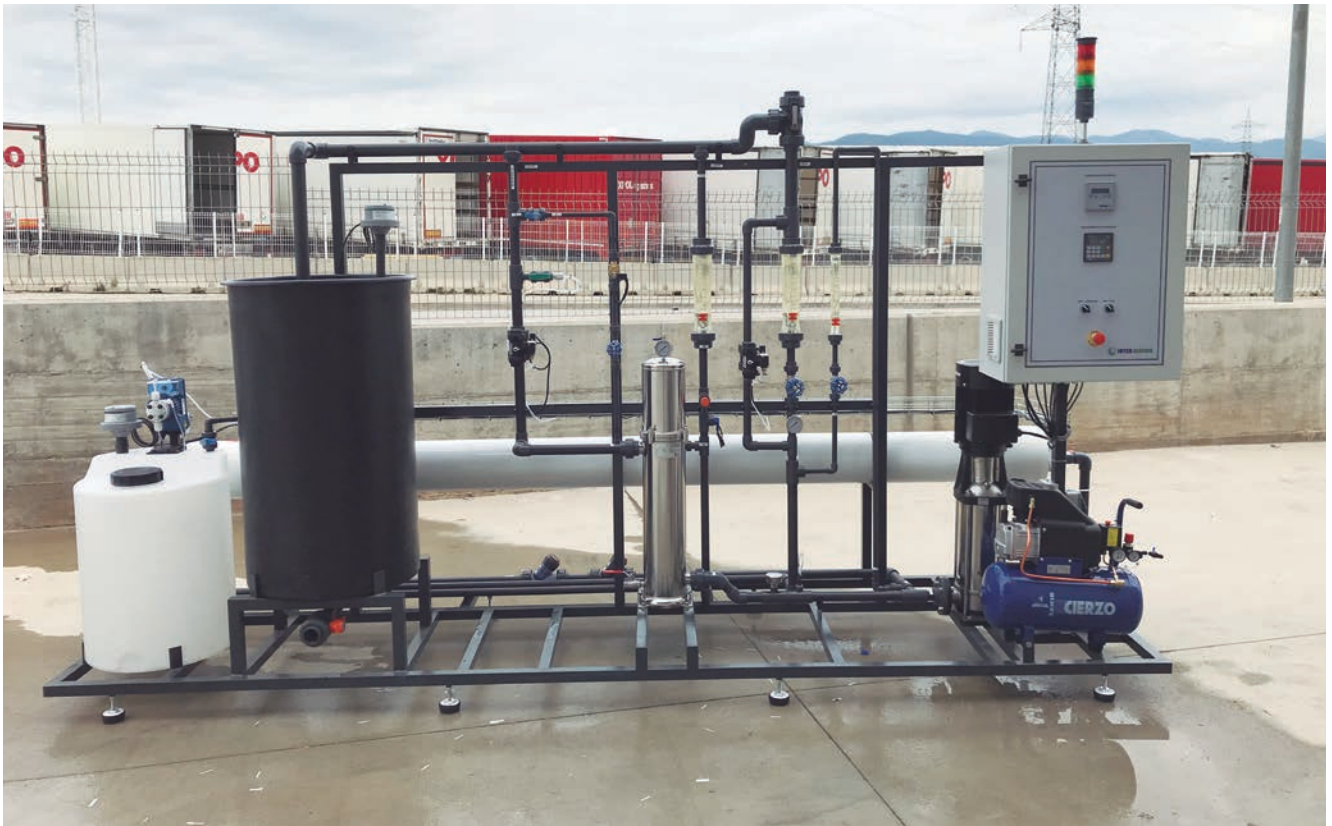
Planta de ósmosis inversa de 60 m 3 /d instalada en Argelia.
