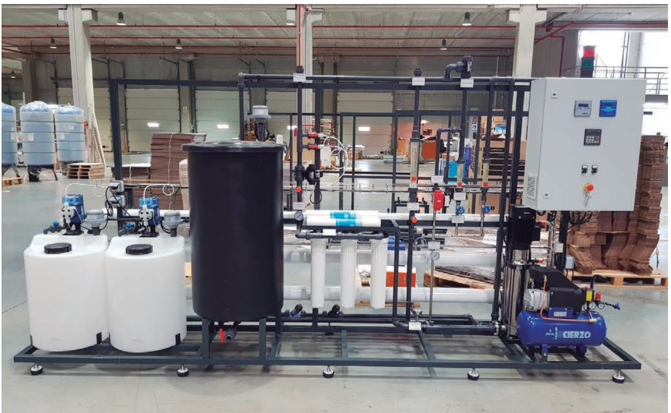
Planta de ósmosis inversa con una producción de 43 m 3 /d para la potabilización de agua de consumo en granja de pollos, instalada en Lérida.
