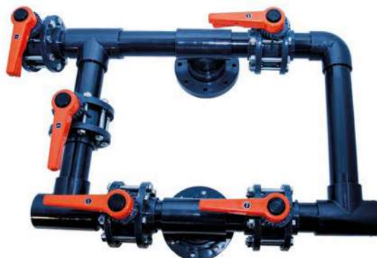
Batería de 5 válvulas con bridas
