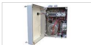
13 Cuadro eléctrico para motor cajón estanco
