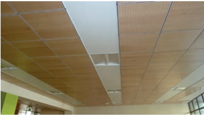
Ejemplo de oficinas con panel radiante a agua TECNA SABIANA PULSAR
