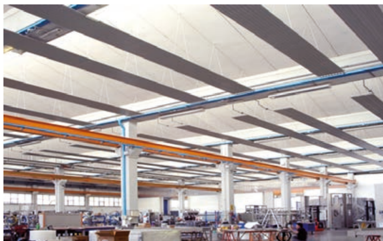
Instalación en fábrica con panel radiante SABIANA: Sin ruido, sin movimiento de aire y con temperatura uniforme en todo el espacio.
