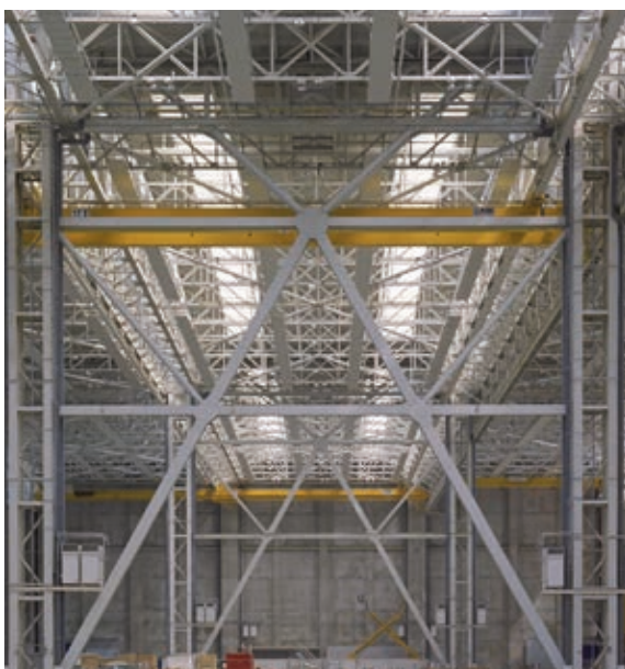
Instalación con paneles radiantes SABIANA a 47 metros de altura
