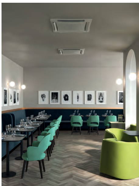
SKYSAFE en falso techo
