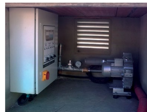
Cuadro eléctrico y compresor
